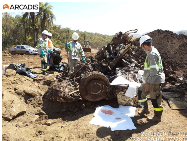
Figura 2 – Equipamento encontrado e posicionamento de manta absorvente
