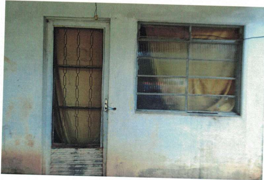
Figura 3: Portas e janelas danificadas
