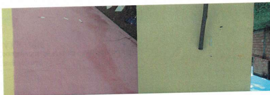
Figura 7: Fissuras em paredes externas.
