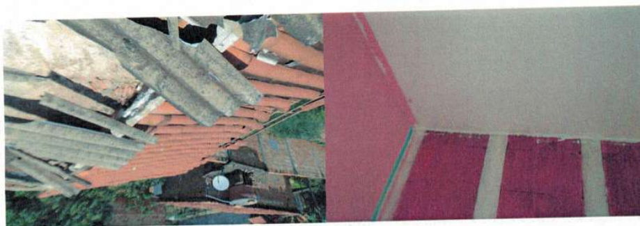
Figura 5: Fissuras aparentes, destelhamento da edificação.
