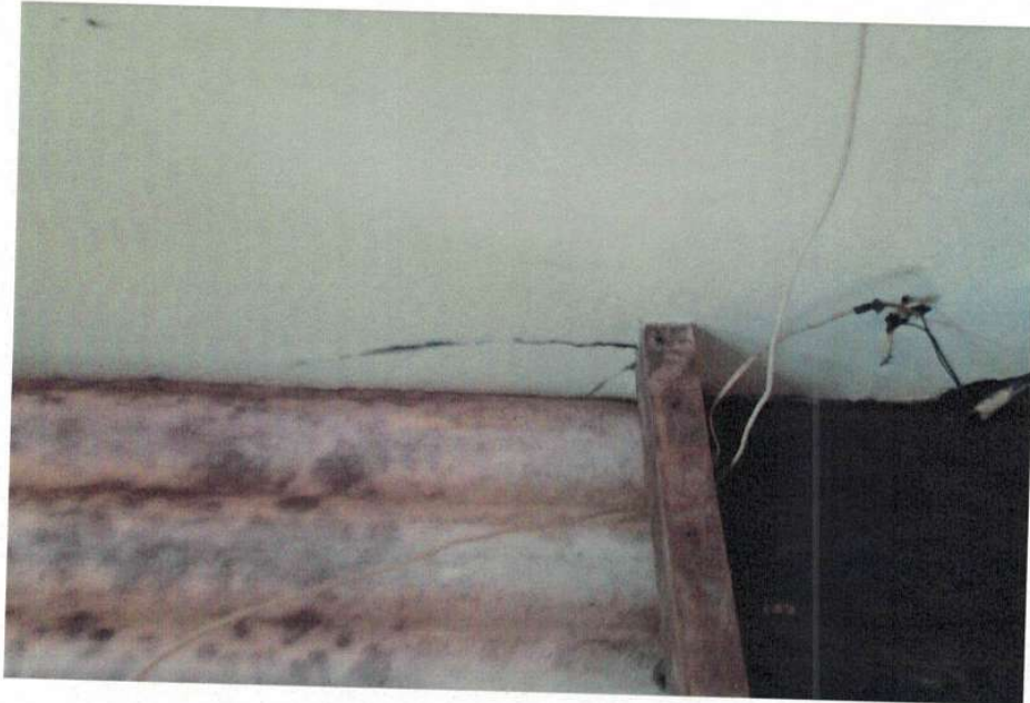
Figura 3: Fissuras e trincas aparentes.
