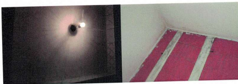
Figura 6: Infiltração em paredes gerando mofo.
