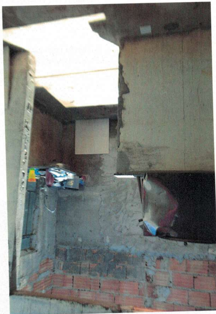
Figura 4: Área da cozinha destelhada.
