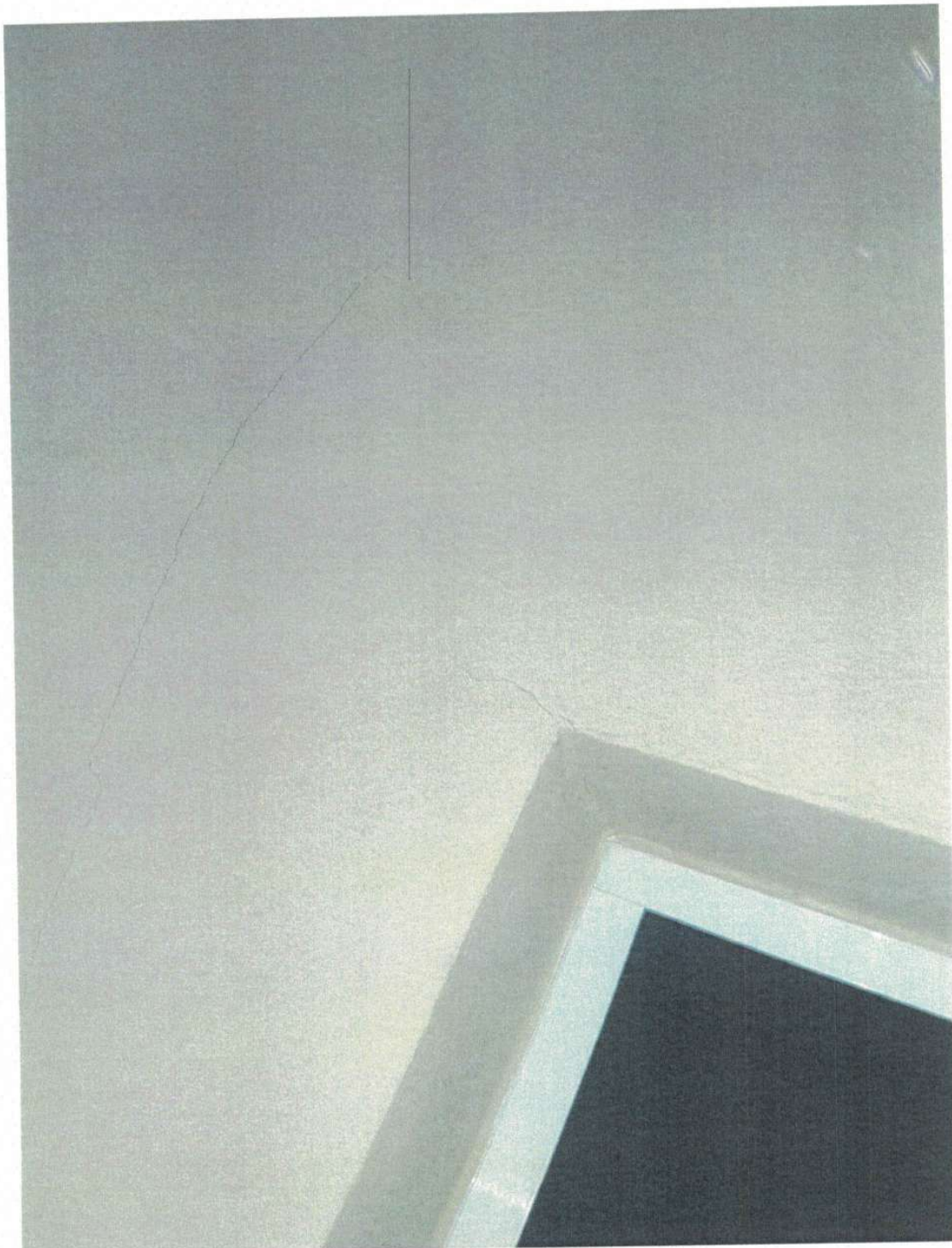
Figura 19 - Fissuras e trincas da cozinha.
