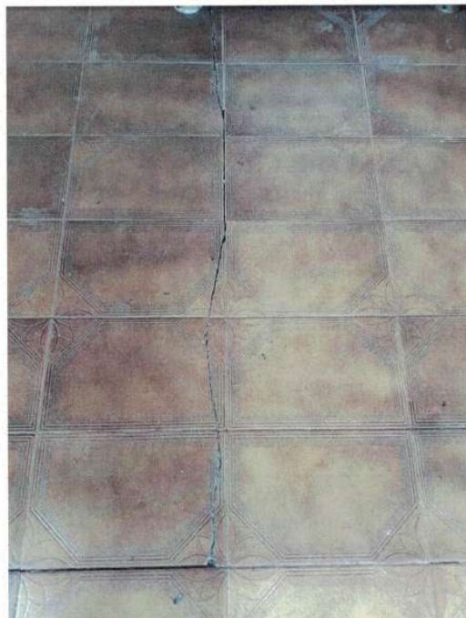
Figura 4 – Trinca no piso da varanda
