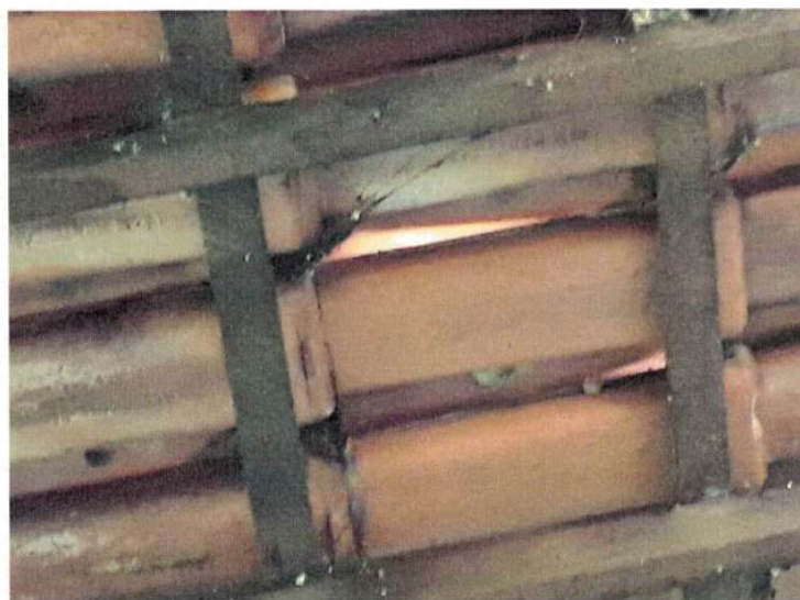
Figura 5 – Frestas devido a movimentação das telhas
