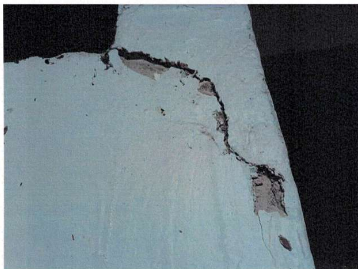
Figura 2 – Trinca na parede da sala de jantar
