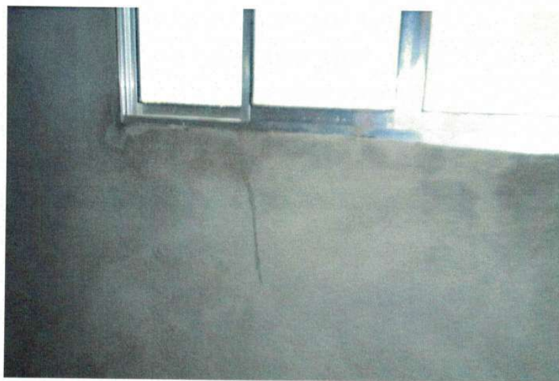
Figura 2 – Trinca aparente na edificação
