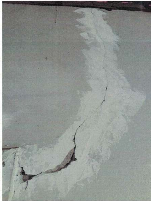
Figura 3 – Trinca na parede da cozinha
