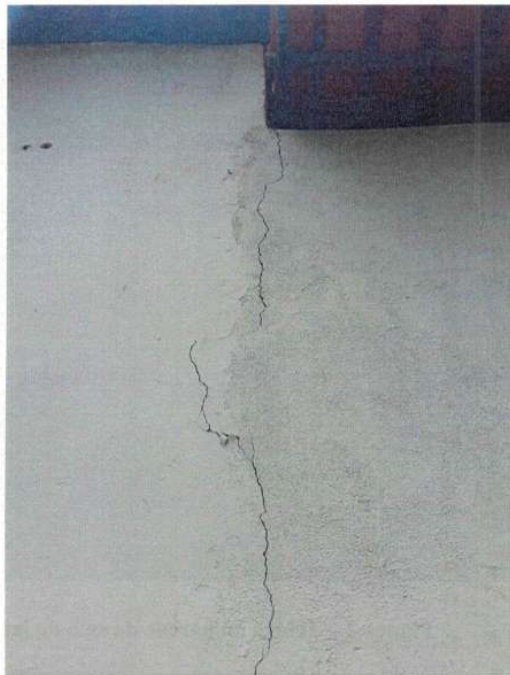
Figura 4 – Trinca na parede externa do quarto
